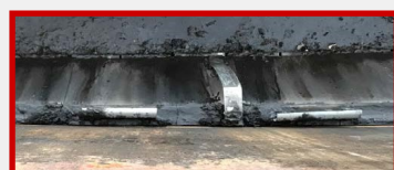
Schlamm auf dem Shunt und Rost auf der Wand
