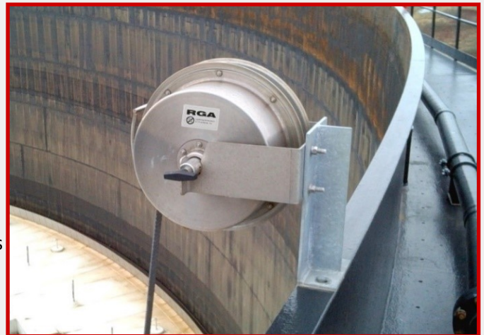
RGA 750 2. Generation montiert an einer vertikalen Abstandshalterung* an einem schwimmenden Dachtank.
